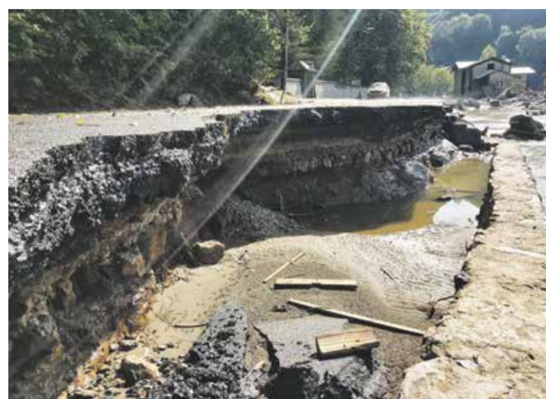
Na Jesenicu povodně napáchaly velké škody na komunikacích. ŘSD je už postupně opravuje. Foto | ŘSD
