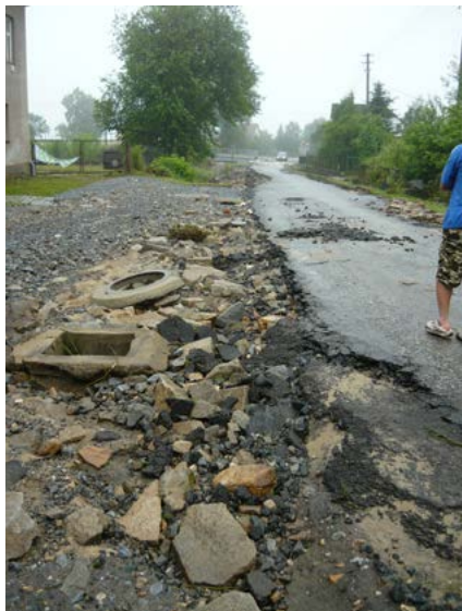
↑ Poškozená komunikace v obci Stará Červená Voda po povodni v červnu 2009, obec Stará Červená Voda
