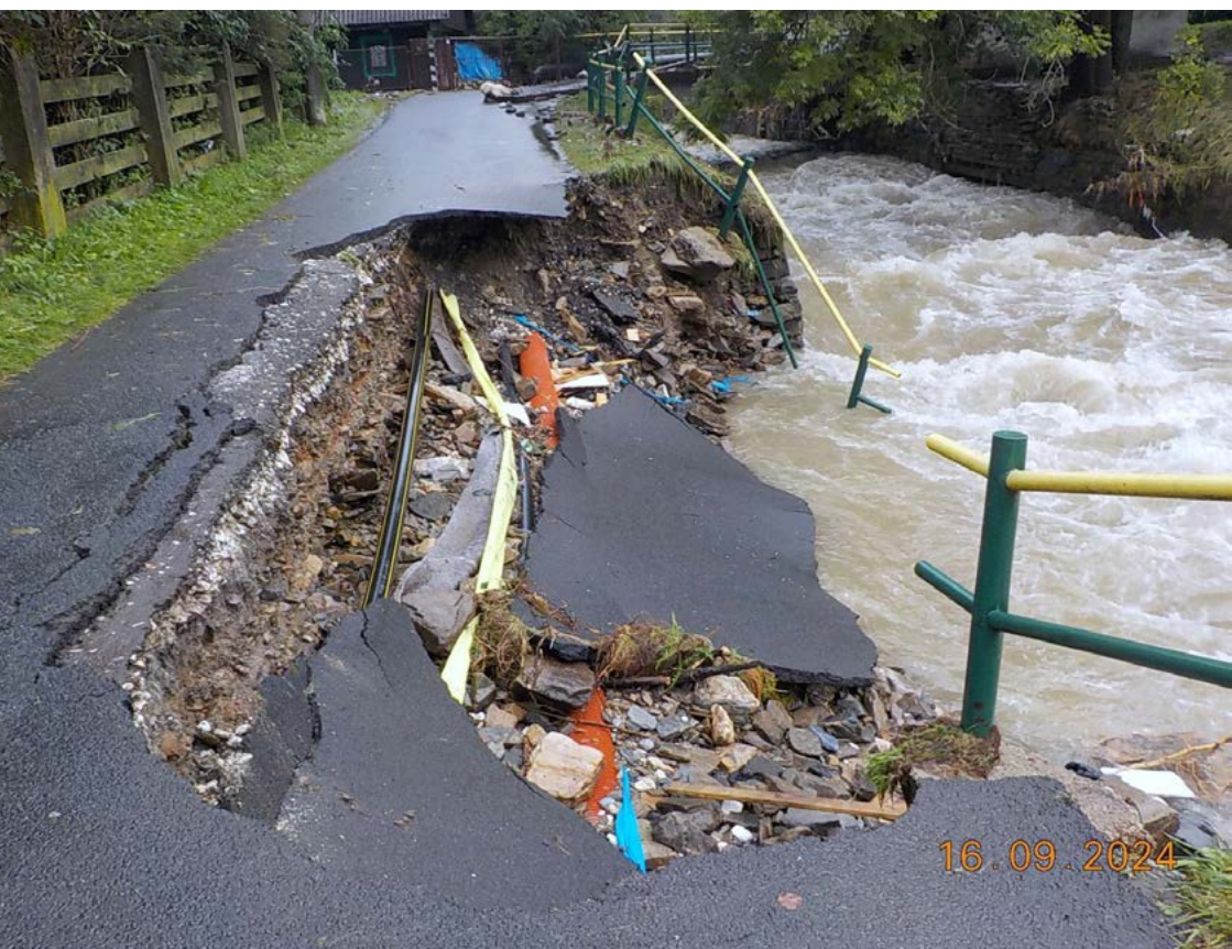
↑ Staříč v obci Lipová-lázně měl obrovskou sílu, vytržený kus cesty s podloží, září 2024, J. Ondryáš
