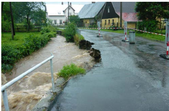
↑ Voda v obci Stará Červená Voda „trhala“ v červnu 2009 i celé kusy vozovky s podložím, obec Stará Červená Voda
